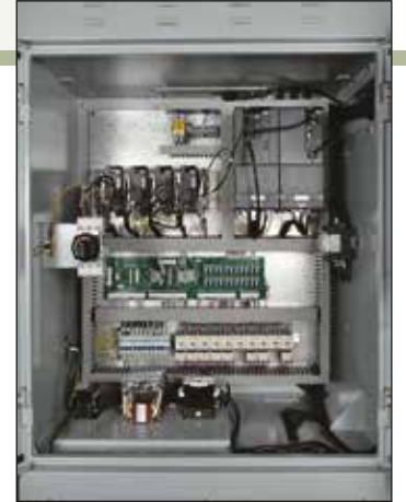
SIEMENS VEYA SCHNEIDER ELEKTRİK KOMPONENTLERİ
