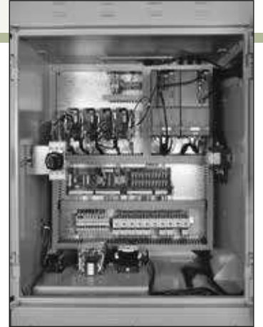
SIEMENS VEYA SCHNEIDER ELEKTRİK KOMPONENTLERİ
